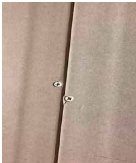
Sönderskruvad gips som skapar en massa extra arbete för målaren.
