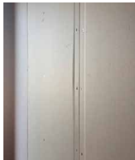
Befintliga skador på uppsatta skivor som är omöjliga att spackla bort.
