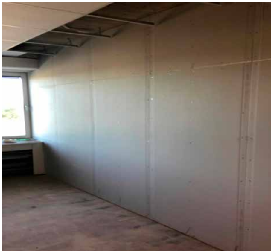
Generalskarv som ger målaren stora problem med att få till en snygg yta.
