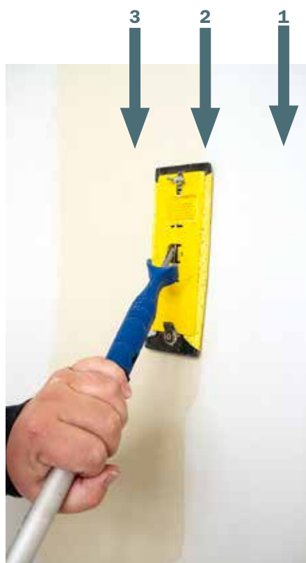
Slipkloss på skarv, pil 1 på den spacklade skarven. Pil 2 bredvid den spacklade skarven och Pil 3 på gipsskivan endast.
